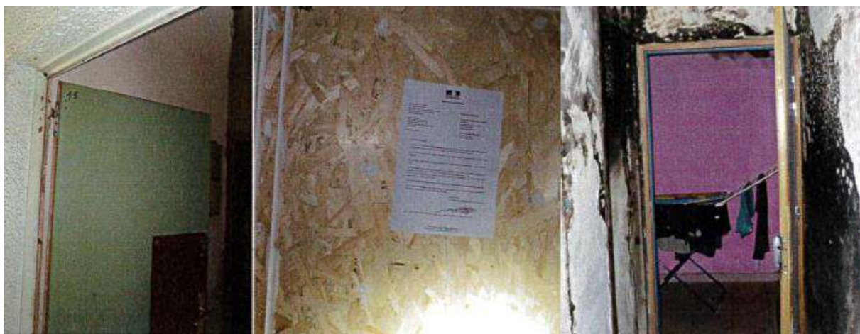
Exemples de portes d'appartement dégradées et cassées (2019/2020)
