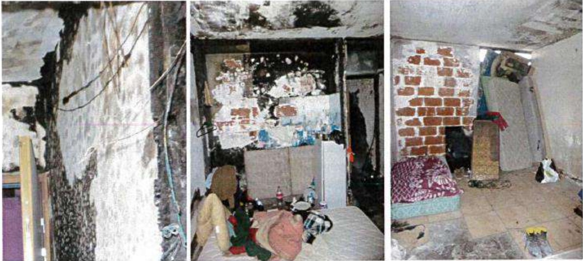
Exemples de fils électriques à nu, absence d'éléments de cuisine, huisseries absentes (2019/2020)
