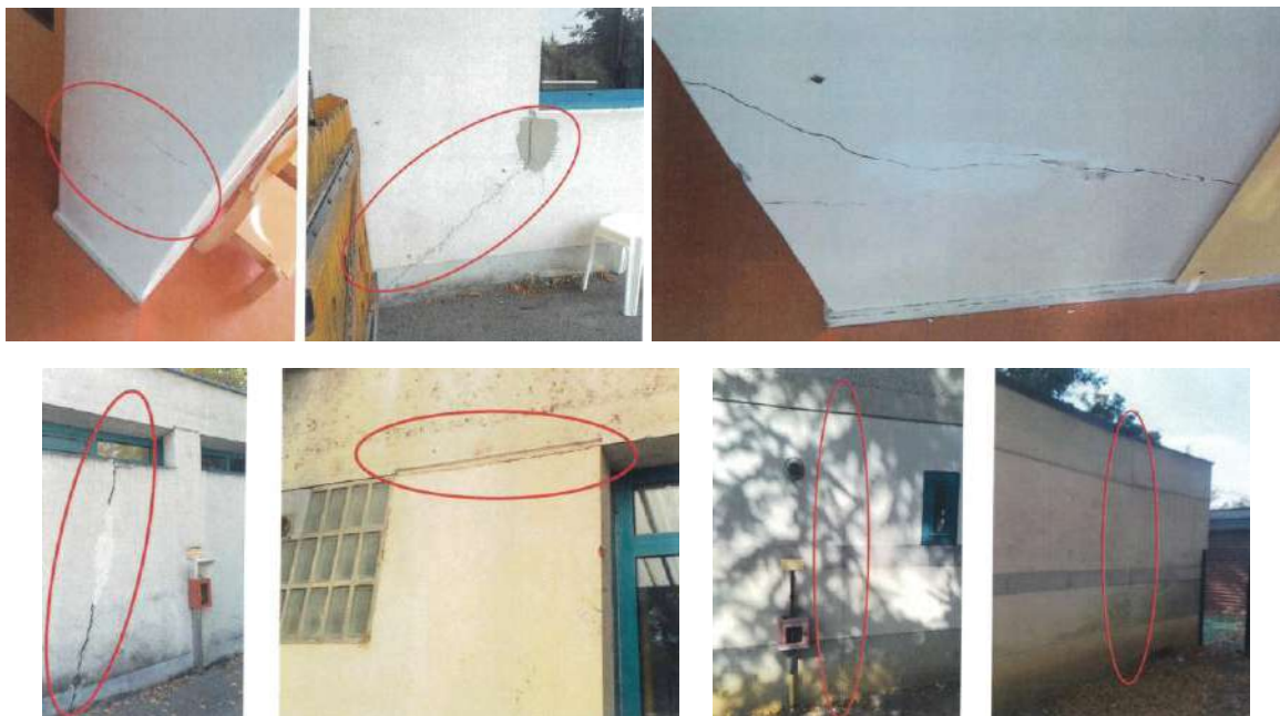
Exemples des fissures apparentes à l'intérieur et extérieur (crèche, épicerie solidaire et billard club)
