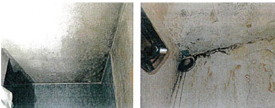
Exemples de moisissure sur le plafond de la salle de bain, ventilation bouchée et défectueuse (2019 /2020)
