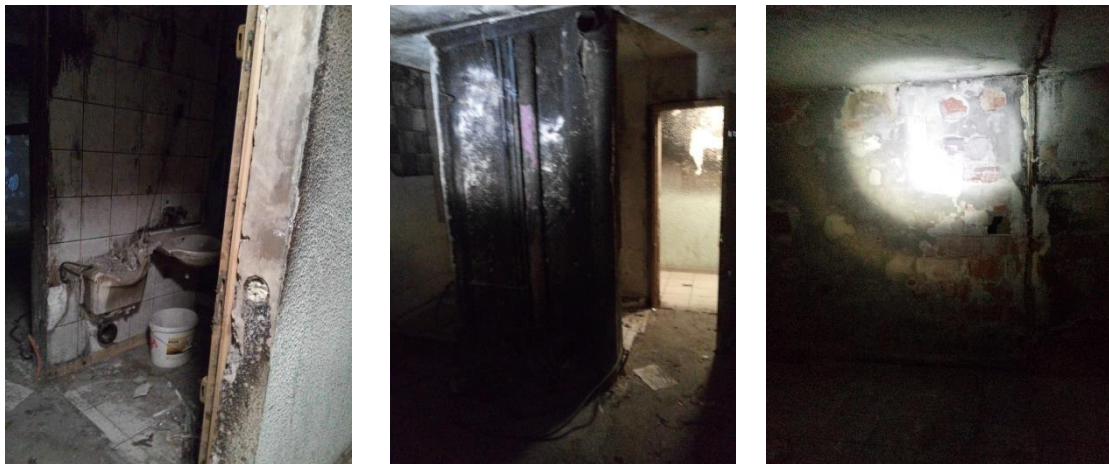
Exemples de photographie de l'appartement N° 54 dévasté par l'incendie de 2017 (2024)
