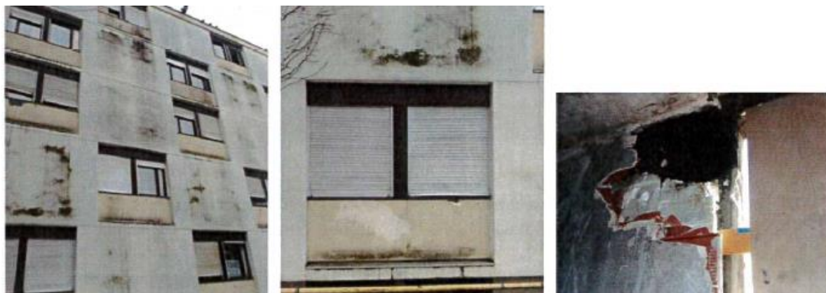
Exemples de dégradation avancée des façades (bâtiments A et B en 2023/2024)
