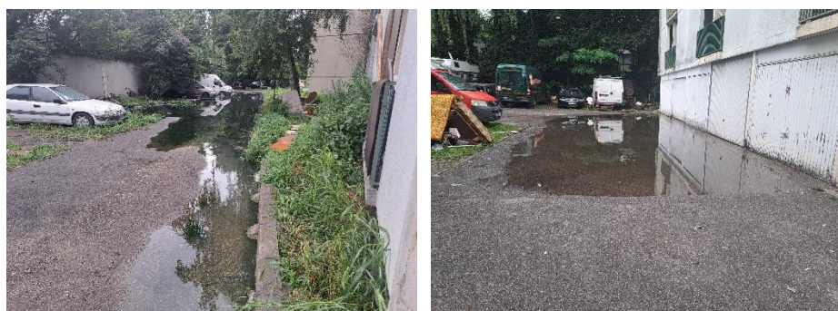
Exemples de canalisation bouchée et d'inondations à l'entrée des immeubles (2024)
