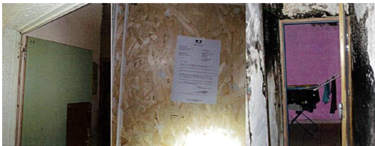
Exemples de portes d'appartement dégradées et cassées (2019/2020)
