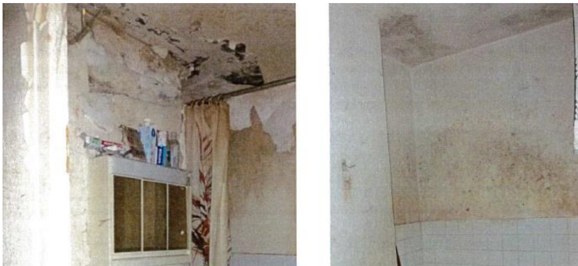
Exemples d'infiltrations d'eau et d'effondrement de plafond (2019 /2020)
