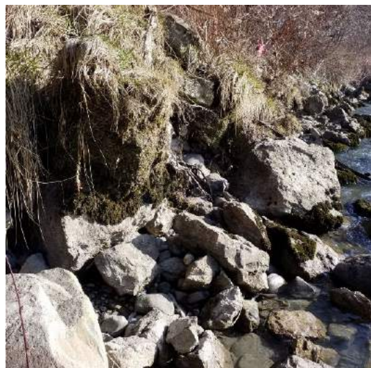
Désassemblage de la protection et érosion en pied de berge
