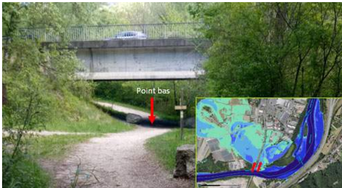
Figure 15 : Point bas du pont de zone causant l'inondation en rive droite (Photo du 06/05/2019)
