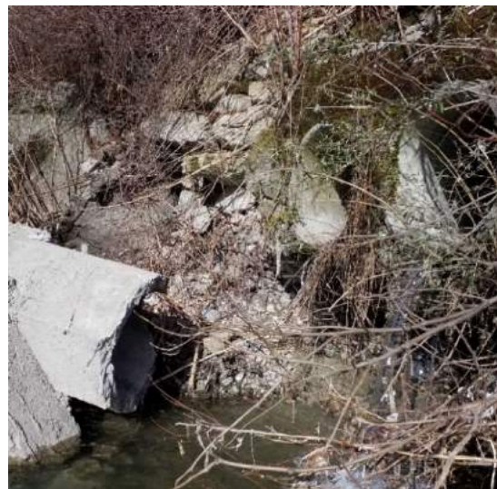
Erosion autour d'un exutoire de canalisation
