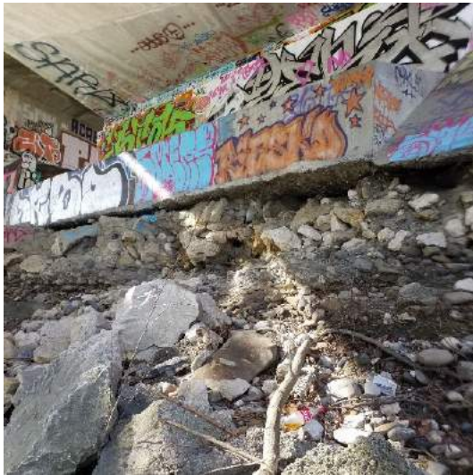
Erosion très marquée sous le pont de l'A41 menaçant la semelle de la pile
