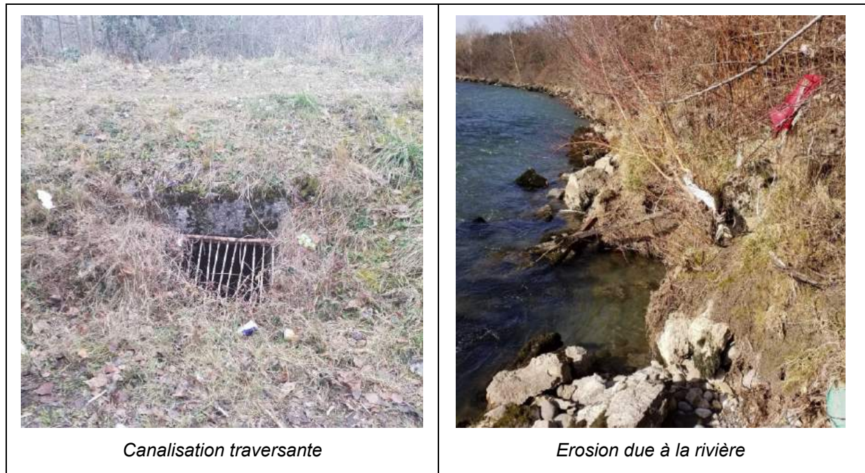
Figure 5 : Illustrations des désordres observés au droit du système d'endiguement (Source : SUEZ Consulting, 21/02/2019)
